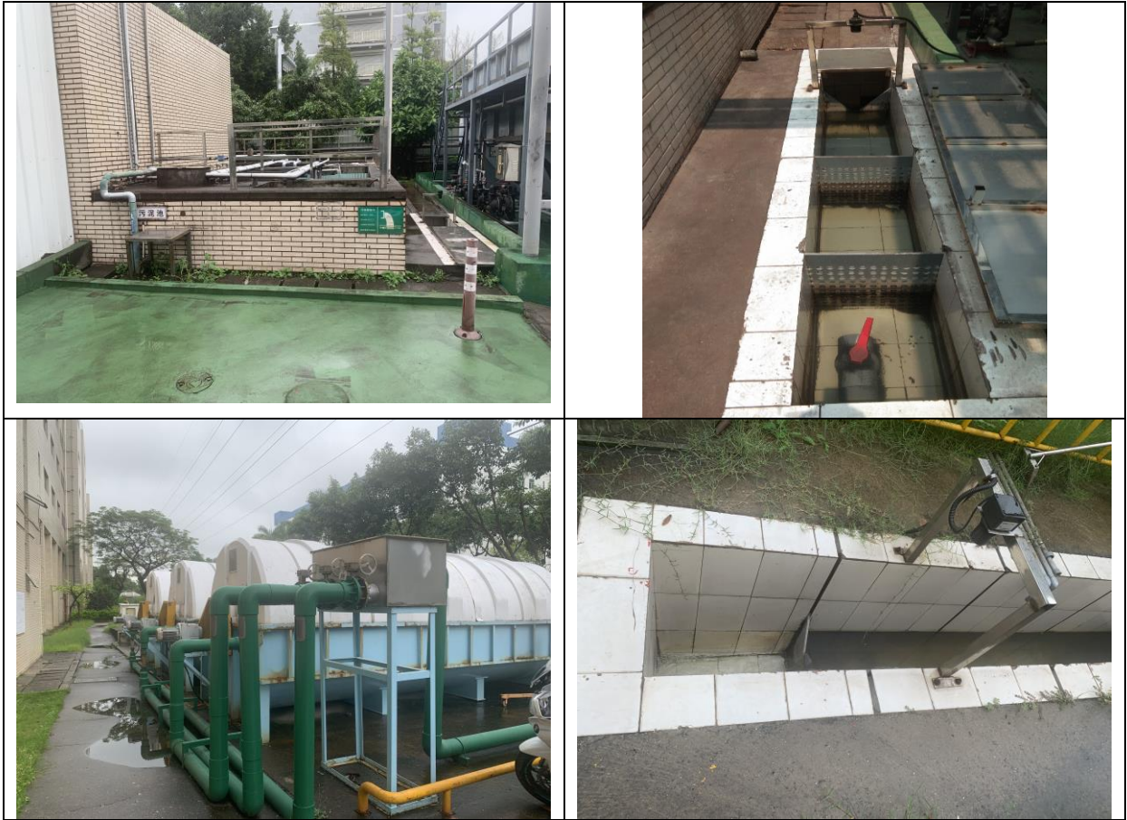
图 3.6-3 厂区污水处理站、排放口照片
