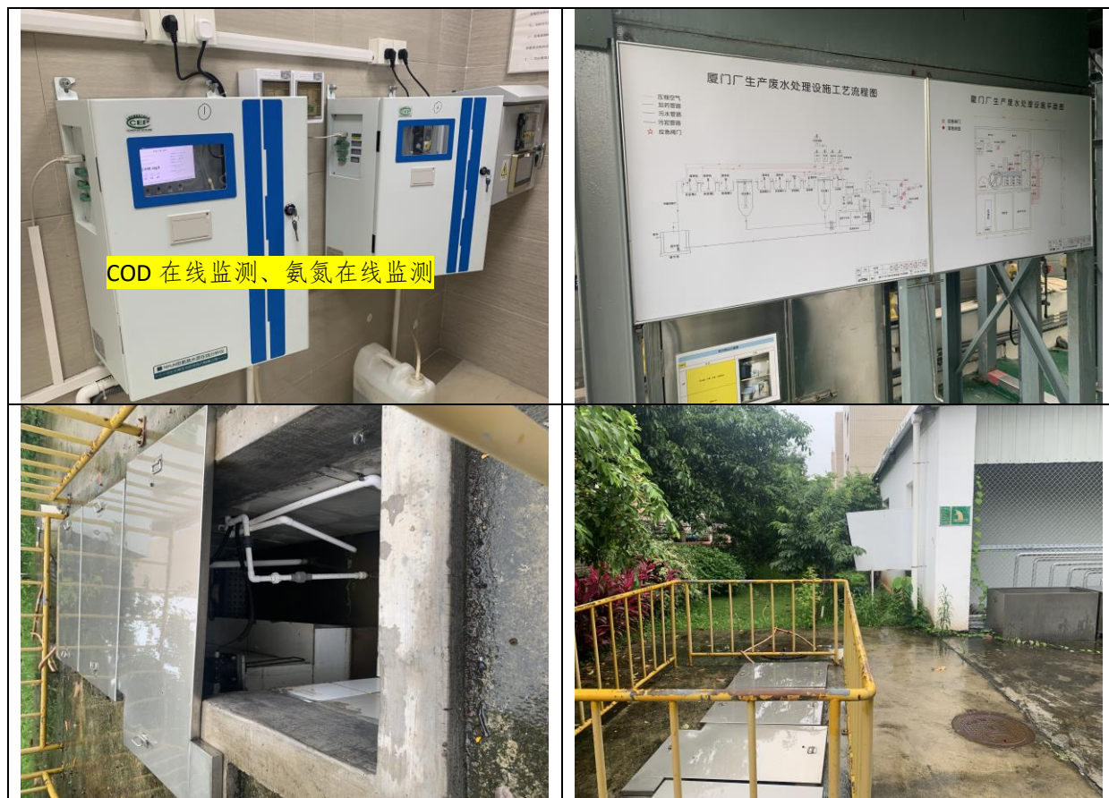
图 3.6-3 厂区污水处理站、排放口照片
