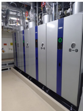
蒸気ボイラ給水の予熱として利用
