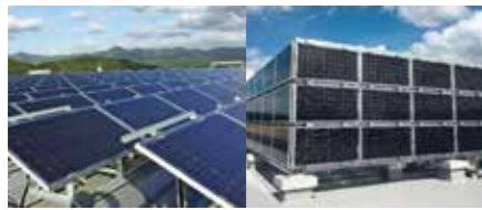
太陽光発電(屋上設置だけでなく、目隠し壁として垂直にも設置)
