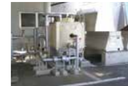
設置されたヒートポンプ式電気加熱設備
