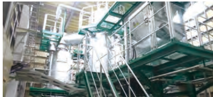
▲ バイオマスボイラ (TDK-MCC株式会社 本荘工場)
