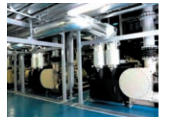
ターボ冷凍機(三隈川工場)
