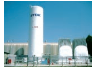
LNGタンク(静岡工場)
