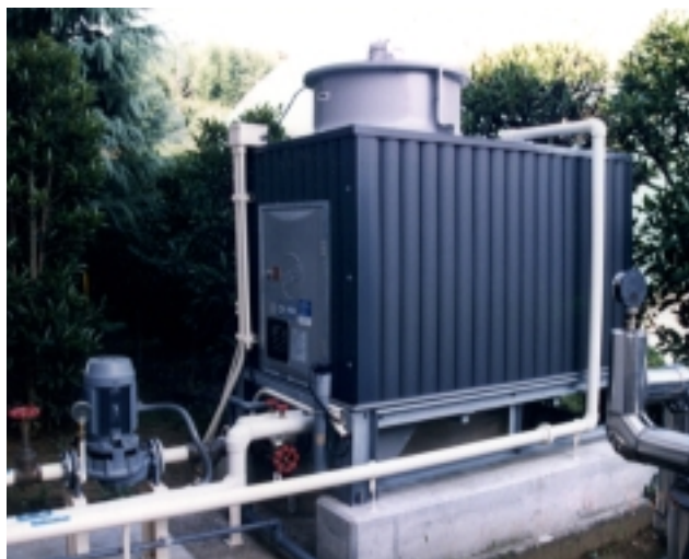
焼成炉の冷却水循環装置（成田工場）
